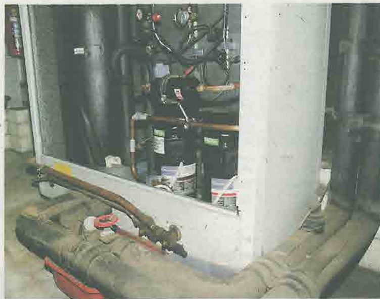
Solekühlung: „Chiller“ mit Kompressionskälteanlage und Kälteübertragung auf Wasser-Glykol-Kreislauf. Fotos: Burkhard Wulf
