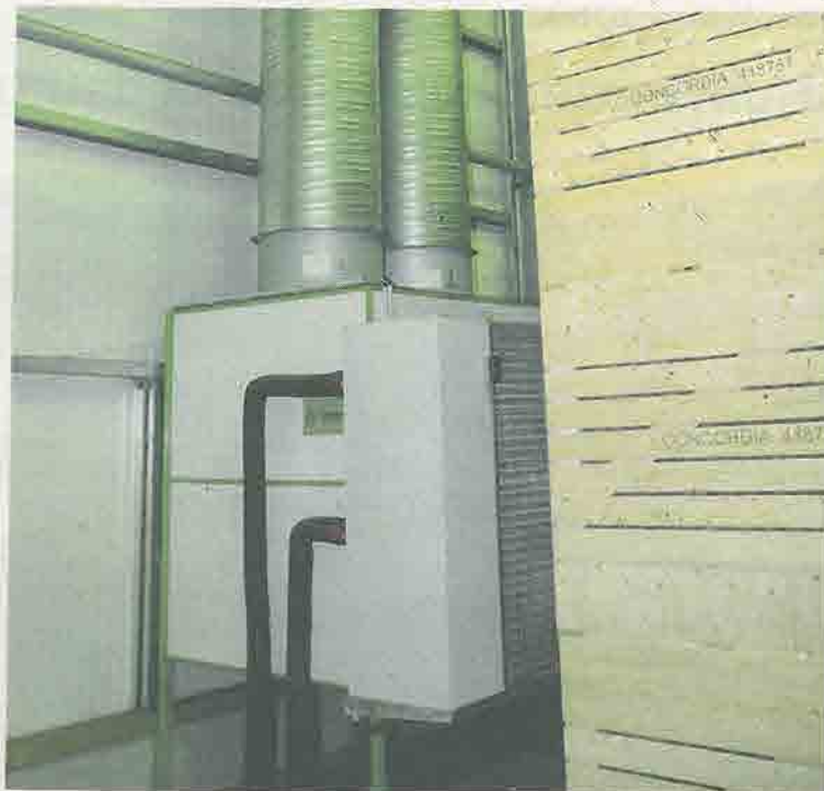
Kompaktkühler mit Außenluftbetrieb bei der Kistenraumbelüftung.
