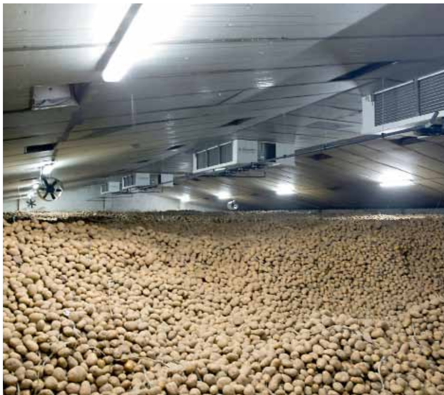
KÜHLUNG Seit Januar 2015 schreibt die EU den stufenweisen Ausstieg aus der Nutzung synthetischer Kältemittel vor. Eine klimaschonende und energieeffiziente Alternative bieten natürliche Kältemittel.
